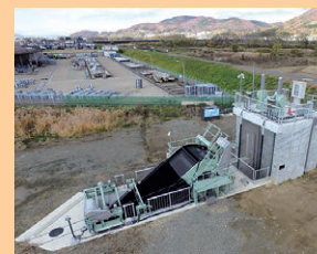
ひがしみるまえ 東見前ポンプゲート場
