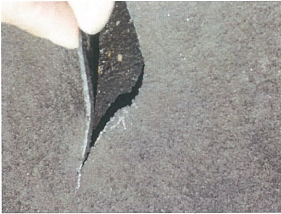
【写真5 防水層の破断剥離】
