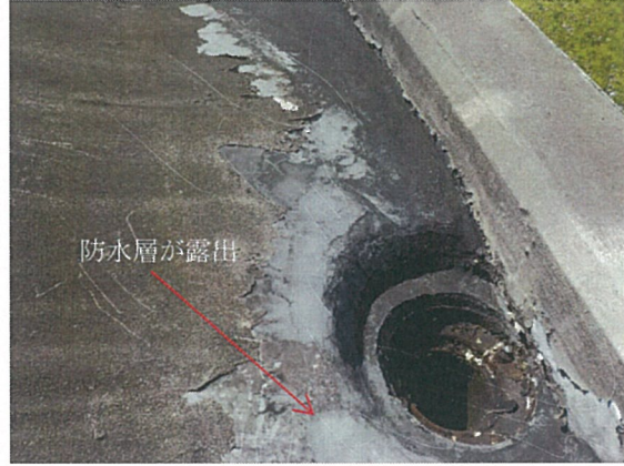
【写真10 水平(水卜)部の保護層剥離】
