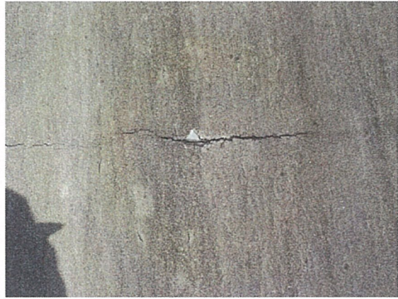
【写真4 防水層のひび割れ】
