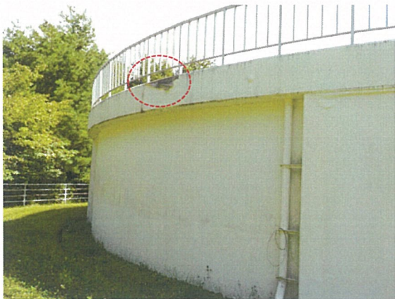
【写真 15 外壁上部の塗膜剥離】
