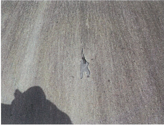
【写真1 防水層の「点」欠損】
