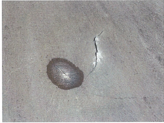
【写真6 防水層の破断剥離】
