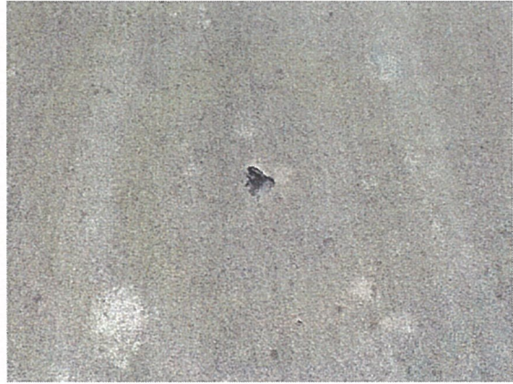
【写真2 防水層の「点」欠損】
