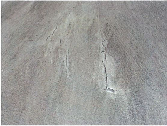
【写真3 防水層のひび割れ】
