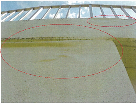
【写真 13 外壁塗膜のフクレ】
