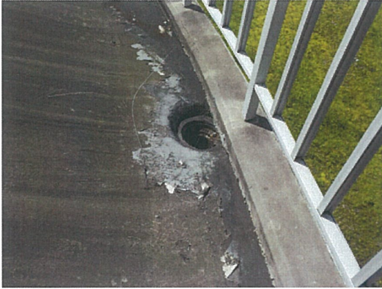
【写真9 水平(水卜)部の保護層剥離】
