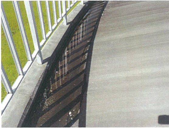
【写真7 斜面部～水平部境界の破断】
