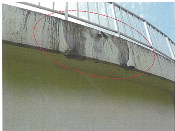
【写真 16 外壁上部の塗膜剥離】
