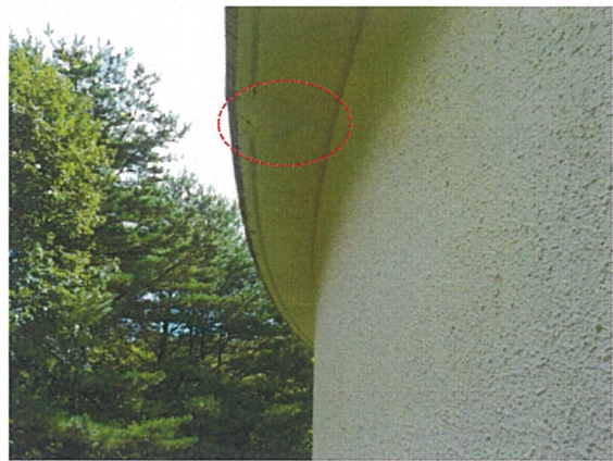
【写真 12 外壁塗膜のフクレ】
