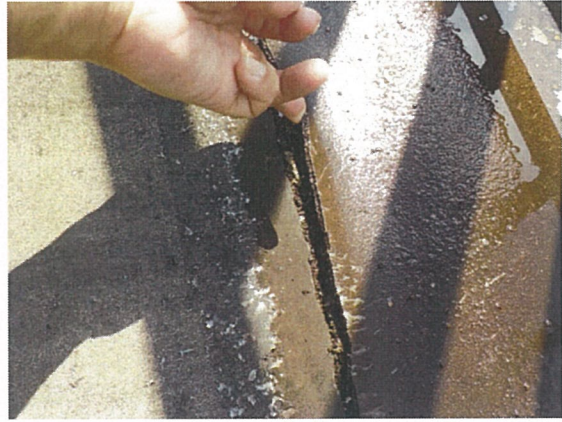
【写真8 斜面部～水平部境界の破断】
