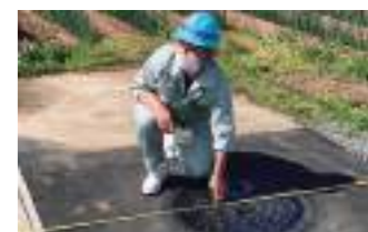
工事の完了検査の様子です。設計どおりのものができているか検査します。
